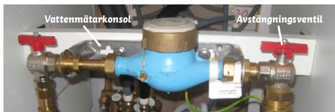
Bild 5 Enkel vattenmätarkonsol med vattenmätare
